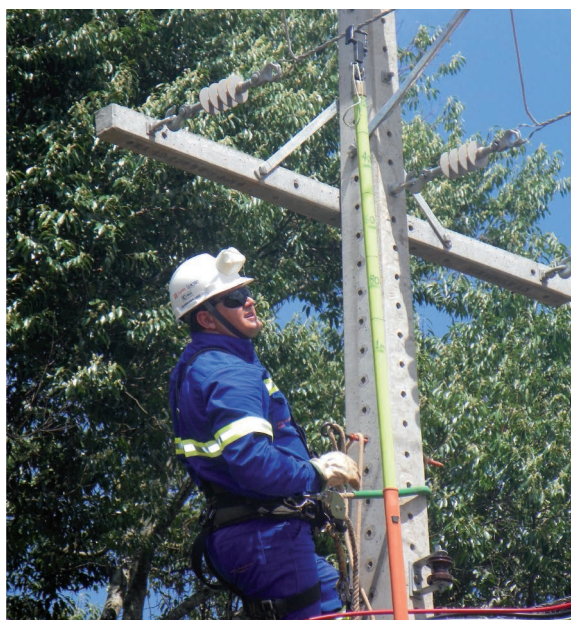
Vista do eletricitista próximo a rede de 13,8KV
